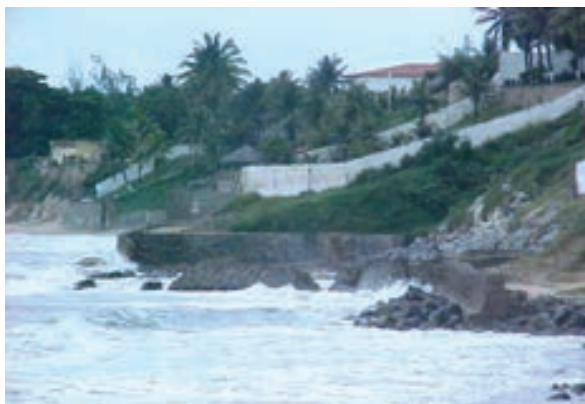
Figura 09. Destruição dos muros das casas e desestabilização de enrrocamentos pela ação erosiva das ondas na praia de Iparana, na Região Metropolitana de Fortaleza.
