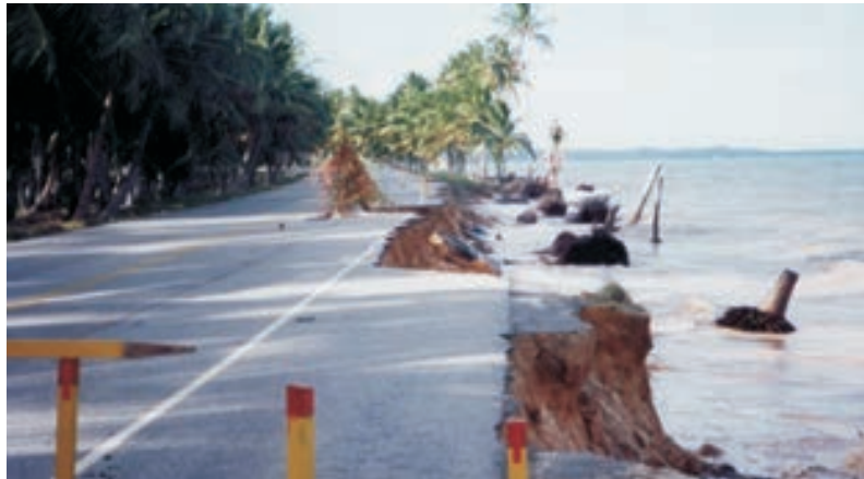
Figura 15. Processo erosivo a sul da desembocadura do rio Maragogi, ameaçando a AL-1001. Vista para norte, em março de 1999.
