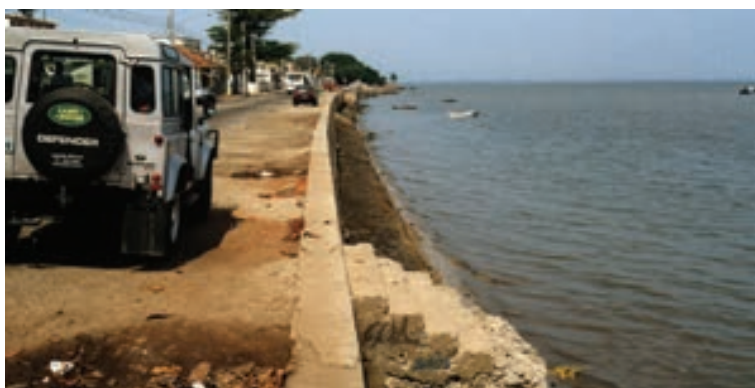
Fig. 27. Sepetiba. Muro de proteção e ausência de praia
