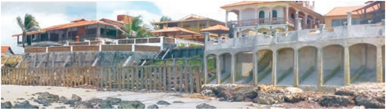
Estampa 3. Estruturas de concreto na forma de muros de arrimo para a proteção às atividades erosivas na praia do Atalaia (Salinópolis – PA).
