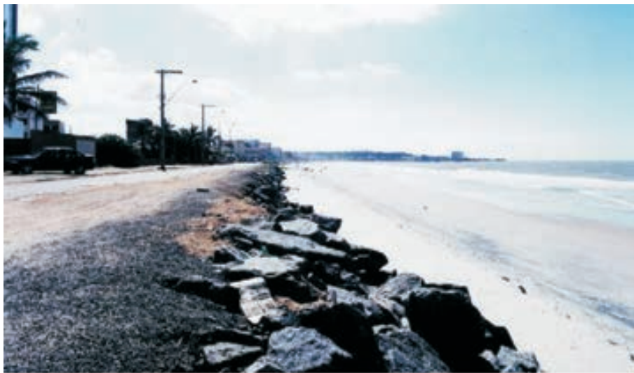
A. Praia de Marataízes, em Marataízes. Processo erosivo intenso com contenção tipo enrocamento longitudinal. Em 2002 foram implementados enrocamentos transversais (molhes). (Agosto de 2000)
