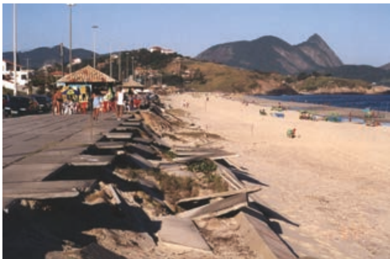
Figura 22. Destruição de muro na Praia de Piratininga.
