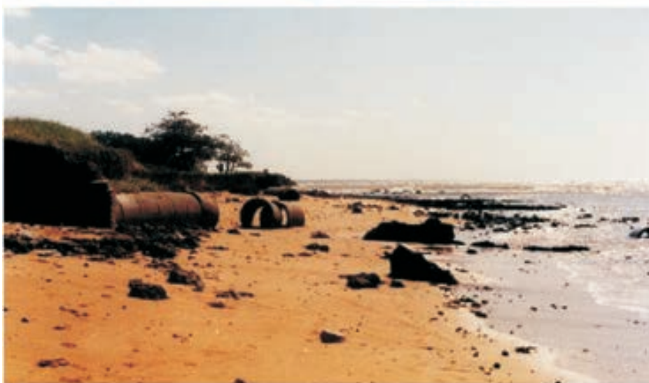
B. Praia de Capuba, no município da Serra. Retrogradação destruindo calçamento e expondo manilhas de esgoto. (Agosto de 2000)
