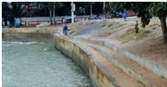
Figura 13b Mesmo local. Tentativa de contenção da erosão. Há sinais de recalque do muro e a praia deixou de existir.
